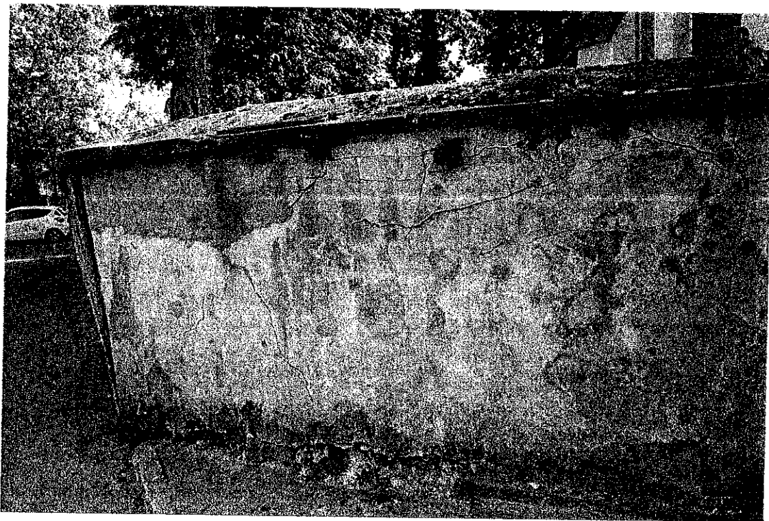
Zdj. nr 3. Mur ogrodzeniowy wraz z dwoma bramami przy kościele św. Mikołaja w Skale. Widok od ul. Kościelnej. Mur jest otynkowany tynkiem wapienno-cementowym. Górna jego część popękała. Betonowe płyty, którymi mur jest przykryty, są w wielu miejscach uszkodzone i pokryte mchem.
